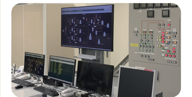
大岳発電所の中央制御室
